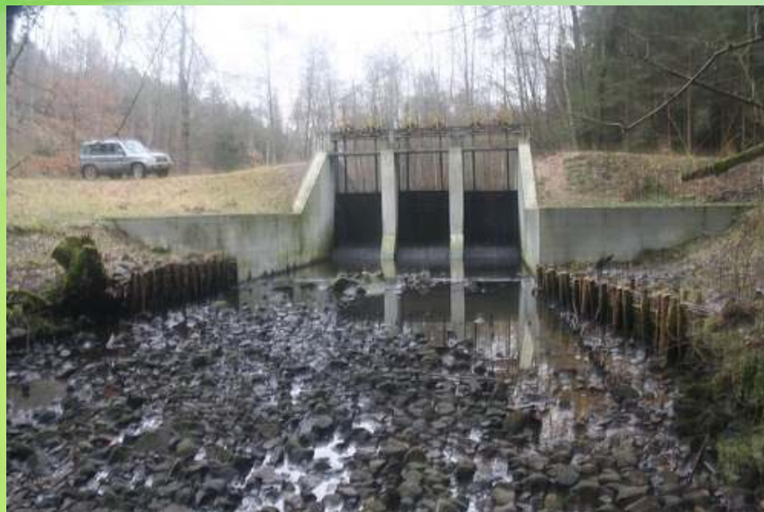
Koryto rzeki Skotawa pozbawione wody
