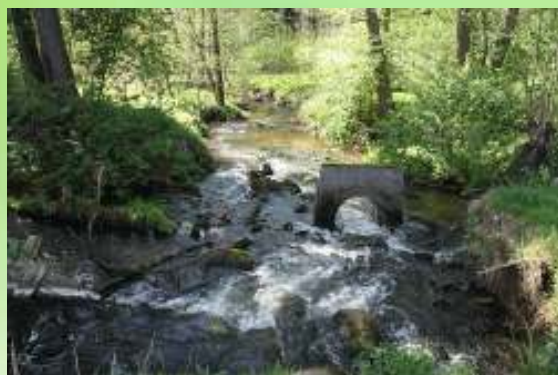
Rozmyty przepust przy starym młynie we wsi Krępa w km 2+970
