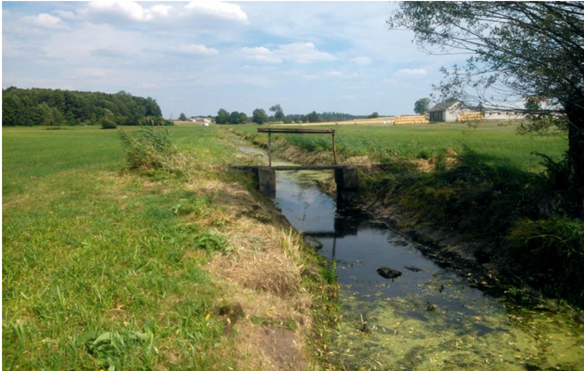
Fot. 15. Zniszczony jaz zastawkowy na uregulowanym strumieniu w krajobrazie rolniczym (fot. P. Prus)
