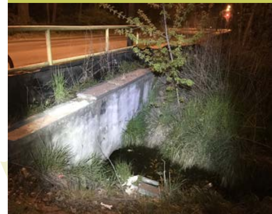
Jeden z kontrolowanych przepustów pod ulicą Piwną w Poznaniu. Fot. Mikołaj Kaczmarski
